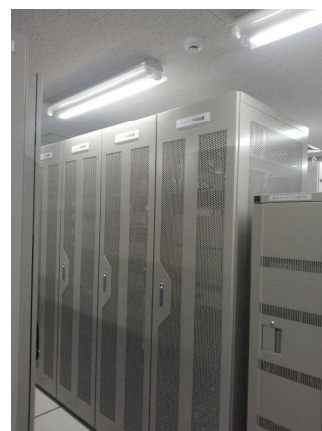
CCTV制御装置
